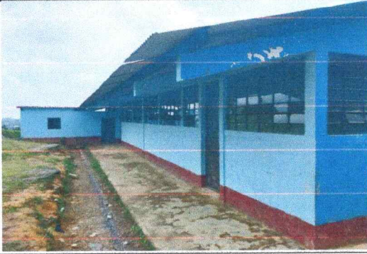
Foto 1: Se observa el deterioro de costaneras
