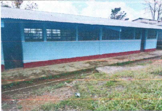
Foto 3: Se observa el deterioro de puertas del módulo de aula
