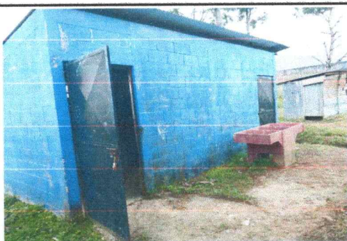
Foto 5: Se observa el deterioro del módulo de baños
