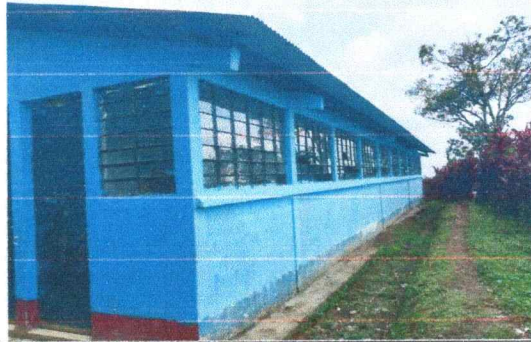
Foto 2: Se observa el deterioro del área de ventanería, piezas de vidrio faltante
